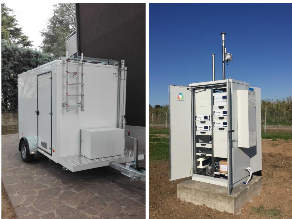
Figura 1: postazione su carrello (a sinistra) e postazione fissa (a destra).
